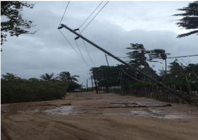
Figura 40-Poste MT inclinado na zona da praia do Barra, Inhambane
