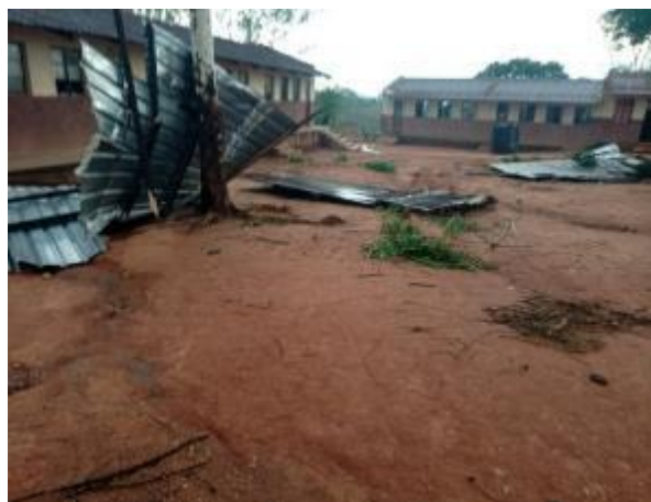
Figura 38-Salas convencionais Destruídas , Distrito de Marupá- Niassa
